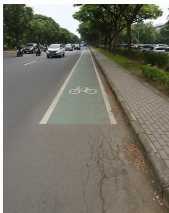
Gambar 1. Kondisi Jalur Sepeda di Jalan TMP Taruna
